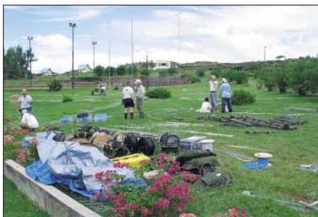
Das Gelände der zukünftigen Antennenfarm, im Vordergrund ein Teil des mitgenommenen Koaxialkabels
