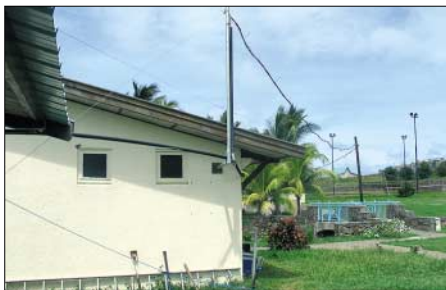
Die Stromversorgung der Stationen wurde durch eine eigens für uns errichtete 44-KW-Leitung sichergestellt
